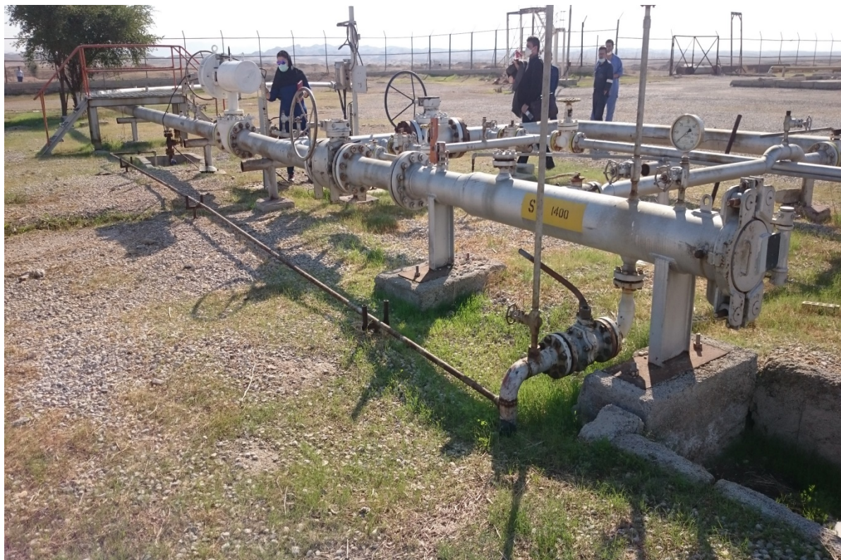
نمونه توپک گیر نصب شده در ایستگاه
