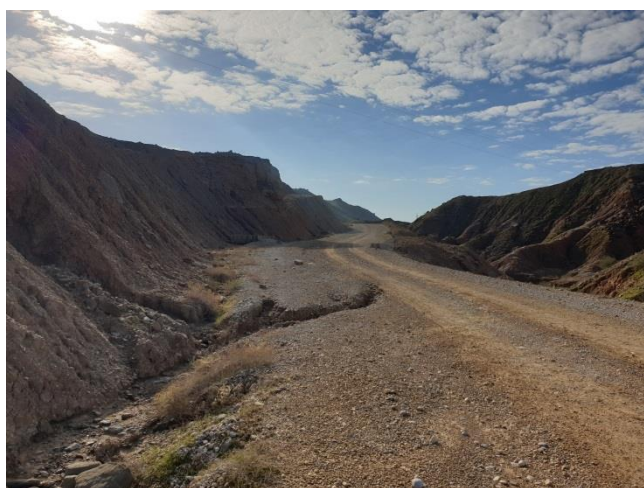
کانال هدایت جریان آب - آب شستگی سطح جاده
