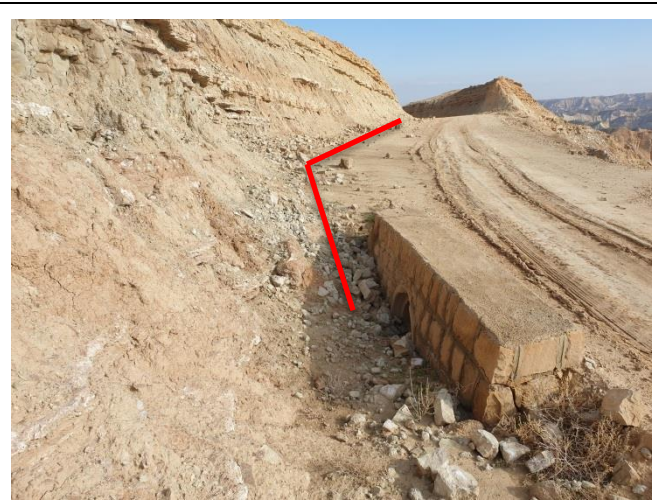
گرفتگی کالورت - مسیر احداث کانال هدایت جریان آب
