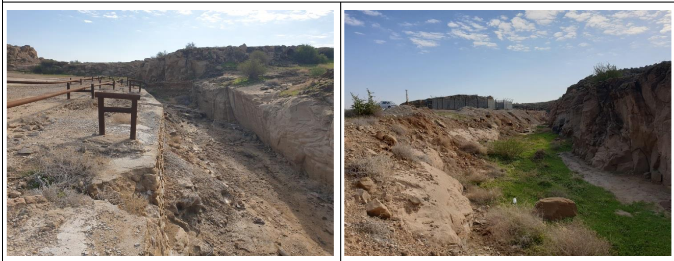
کانال هدایت آب و گل و نمایی از تخریب دیوار حائل سنگی
