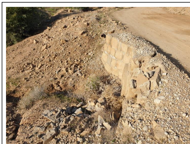
تخریب بخشی از سنگ چینی
