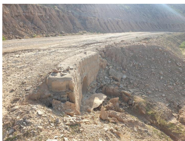
وضعیت کالورت که دچار آب شستگی شده است
