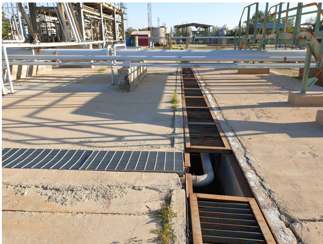
کانال های انتقال آب و روغن به سمت حوضچه Oily water separator
