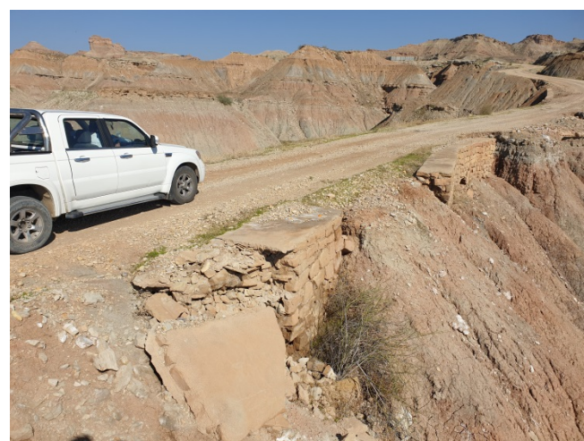
وضعیت نامناسب و تخریب دیوار سنگی
