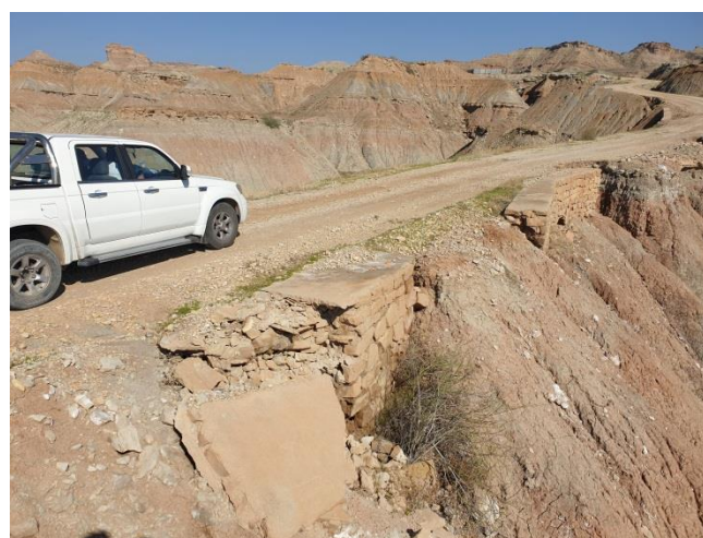
وضعیت نامناسب و تخریب دیوار سنگی
