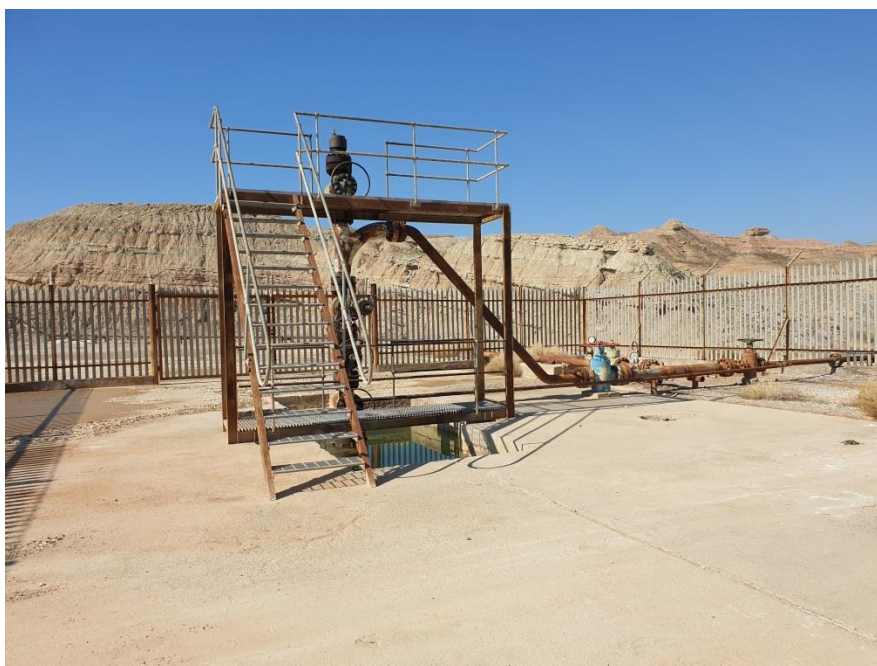
نمایی از محوطه داخل فنس و اطراف سر چاه تعمیراتی BK15- جمع شدن آب تا لبه سر قابل توجه است
