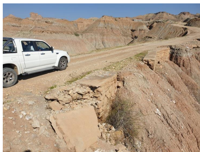
وضعیت نامناسب و تخریب دیوار سنگی
