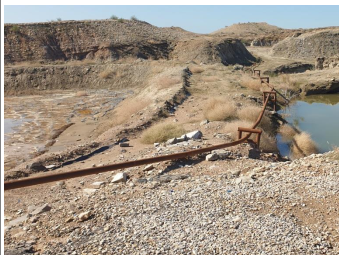
نمایی از خط لوله گودال سوخت و مجاورت آن با گودال آب و گل
