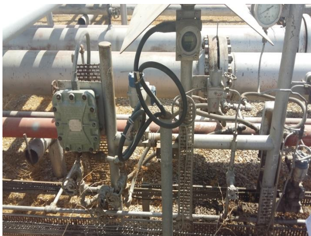
نمایی از اتاق کنترل موجود و سینی کابل های کارشده در محوطه
