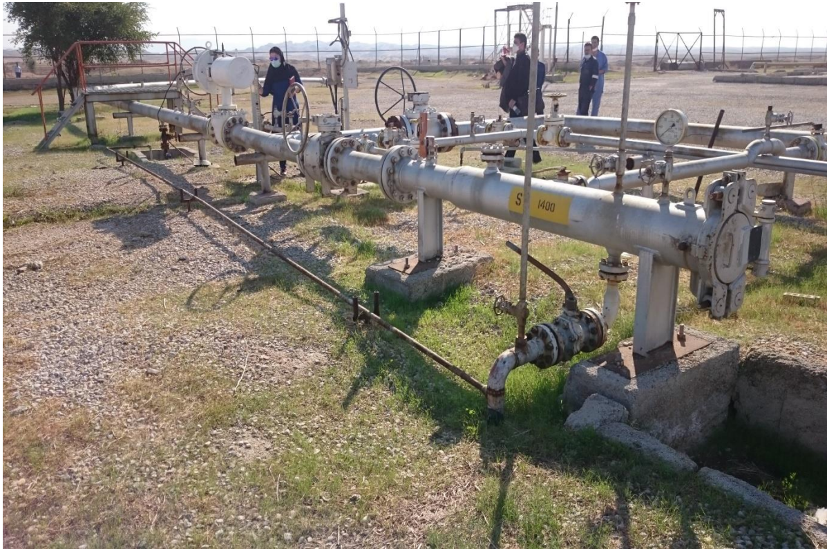
نمونه توپک گیر نصب شده در ایستگاه
