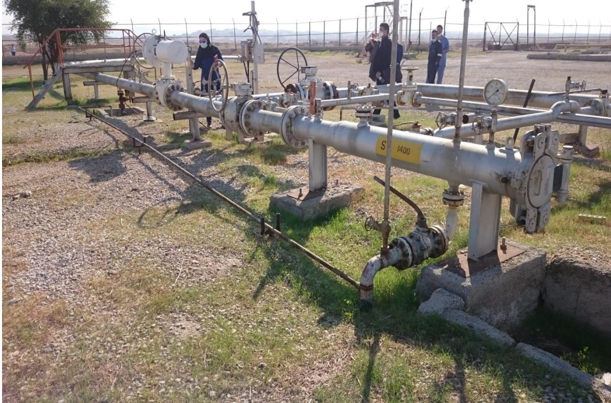
نمونه توپک گیر نصب شده در ایستگاه
